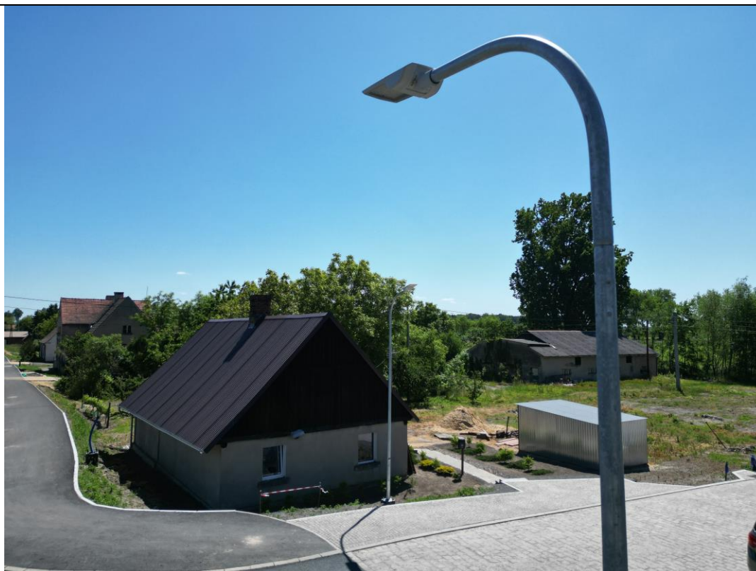
Zdjęcie 10. Oświetlenie uliczne w Tylewicach.
